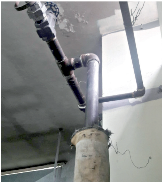
Figura 4. Tubería sin aislante
