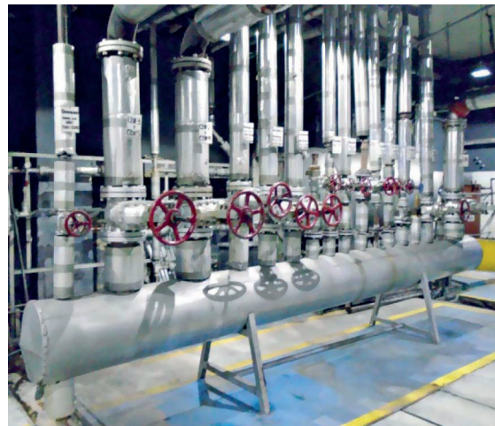
Figura 2. Distribuidor de vapor
