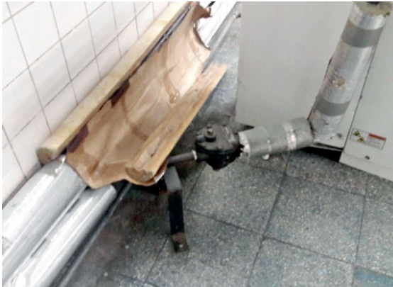
Figura 3. Tubería con aislante deteriorado
